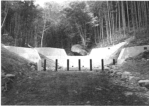
3か年緊急対策で整備した流木補足工
