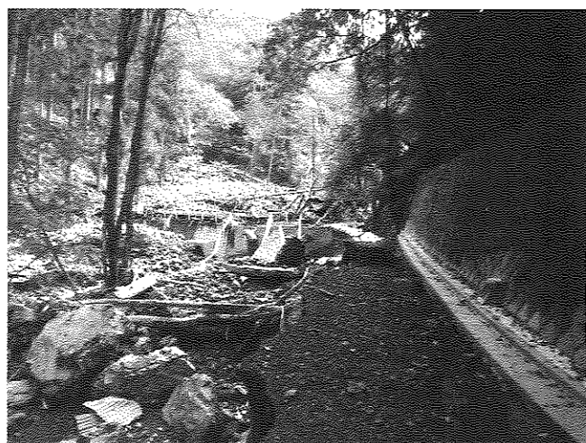
被災状況 林道上野大滝線（上野村）
