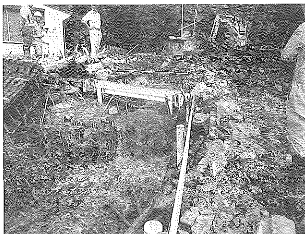
道路上に土砂堆積
