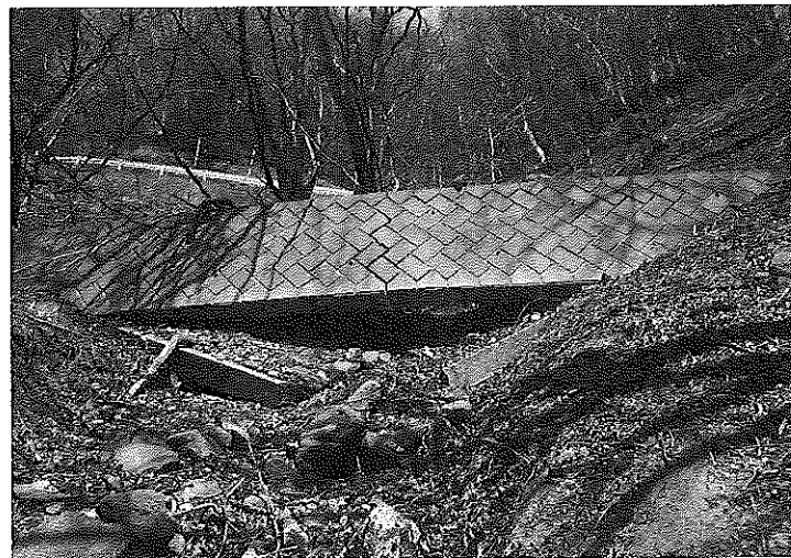
基礎部が流出し不安定化した土留工
